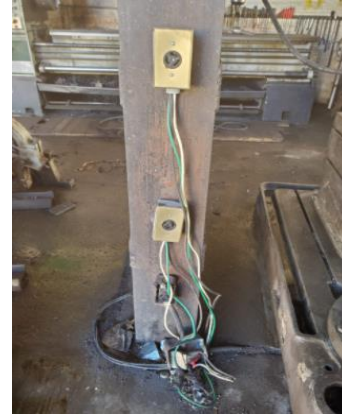
Fig. 5. malas condiciones eléctricas y de delimitación de áreas
